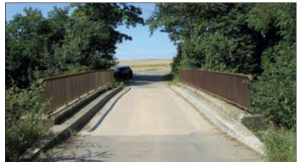
Brückenfahrbahn vor der Sanierung Foto: Amt für Landentwicklung und Flurneuordnung Gotha (August 2012)
