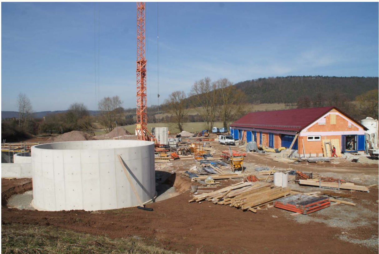
Neubau der Kläranlage Untermaßfeld mit einer Ausbaugröße von 3.700 EW Betreiber: Kommunaler Wasser- und Abwasserzweckverband Meininger Umland
